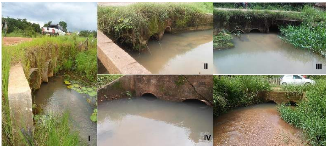
Figura 3: Tubos e canal I - no bairro Umarizal; II e III no bairro Patauateua e IV e V no bairro Maurício Ataíde;
